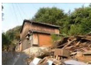
自然倒壊した空き家
